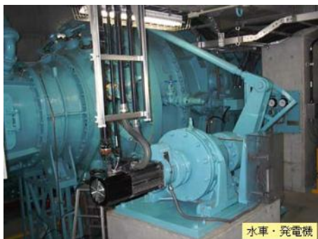
水車・発電機
